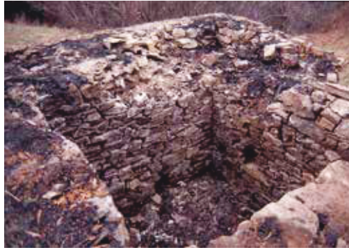
Der steinerne Unterbau der Feldscheune nach dem Brand 1992 Foto: Volkmar Geupel
